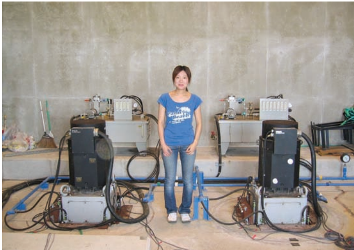
兵庫県淡路市の野島断層近傍にあるアクロス震源装置。地上部がモータとファンで、錘はその下に埋設されています。詳しくは、p.2の記事「地震予知の新兵器：アクロス」をご覧ください。
