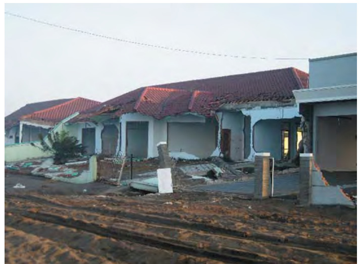
写真2 損傷した石造建築 (Pangandaran 郡)
