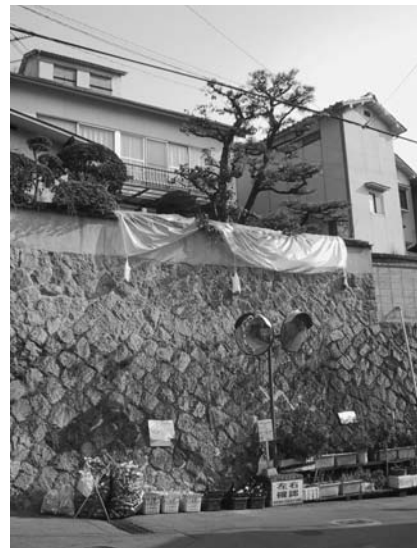
写真2 よう壁の被害（呉市両城地区）
