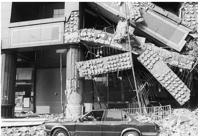
写真1 台中市内で被害に遭った高層ビル。崩れてむき出しになった部分を見るとコンクリートの中には缶が埋められているのがわかる。すぐ近くにこのように大きく壊れたビルは見当たらなかった。
