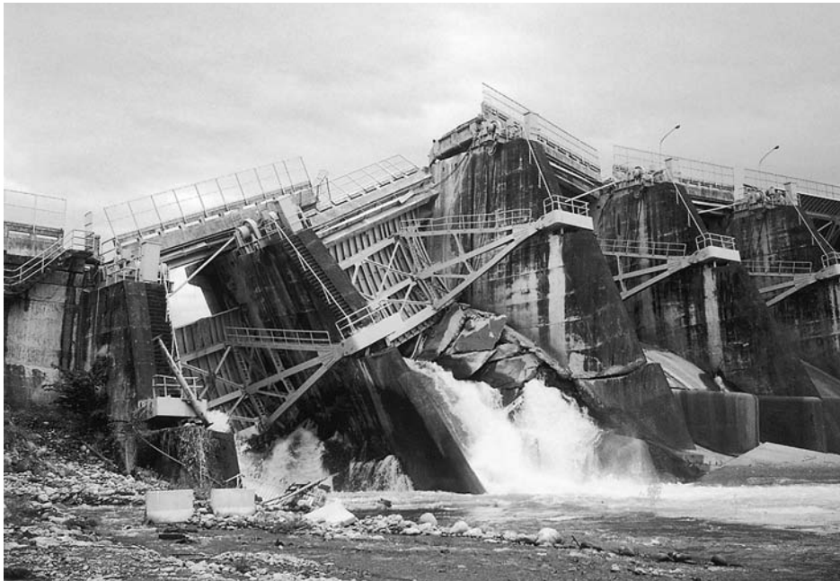
地表地震断層の北端に位置する石岡ダムは被害。集集地震の発生にともなって、河床に約8mの段差が生じ、ダムは完全に決壊した。河井正氏（電力中央研究所）撮影・提供。
