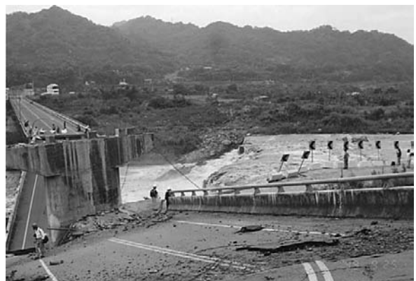
図2 断層変位により断ち切られた橋。上流側には新たな滝が出現した(豊原市郊外)。
